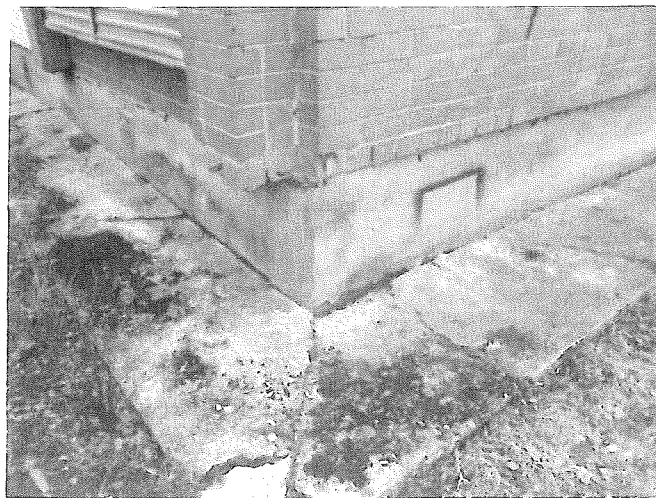
3.attēls. Ēkas betona apmales stāvoklis ir neapmierinošs, pēc cokola siltināšanas to nepieciešams atjaunot.
