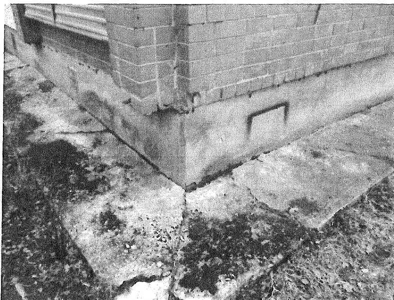
3.attēls. Ēkas betona apmale vietām sēdusies. Konstatēta tās plaisāšana un daļēja aizaugšana ar zālēm.
