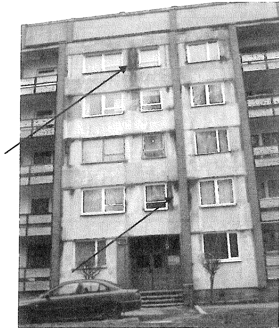
1.attēls. Ēkas fasāde, ir redzams mitrums ap atsevišķām logu ailēm.
