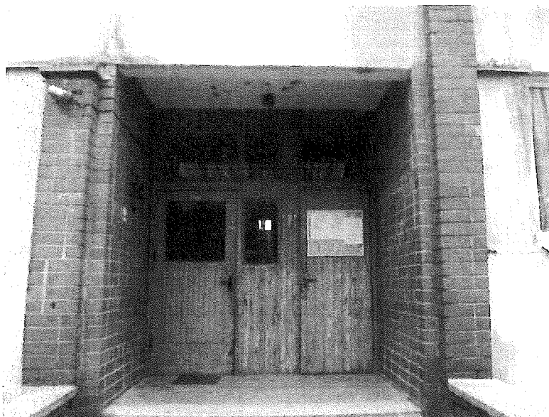
1.attēls. Ēkai uzstādītas koka ārdurvis. Tās nav noblīvētas pietiekoši blīvi, ieteicama durvju nomaīņa.
