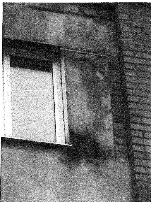
2.attēls. Ēkai jumtiņu izvīzījumiem nav izveidota lietus ūdens noteku sistēma. Lietus ūdens pa konstrukcijām tek uz leju un bojā tās.
