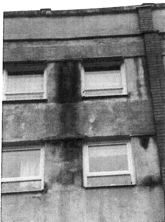
4.attēls. Mitruma ietekmē bojātas ēkas sienu konstrukcijas.
