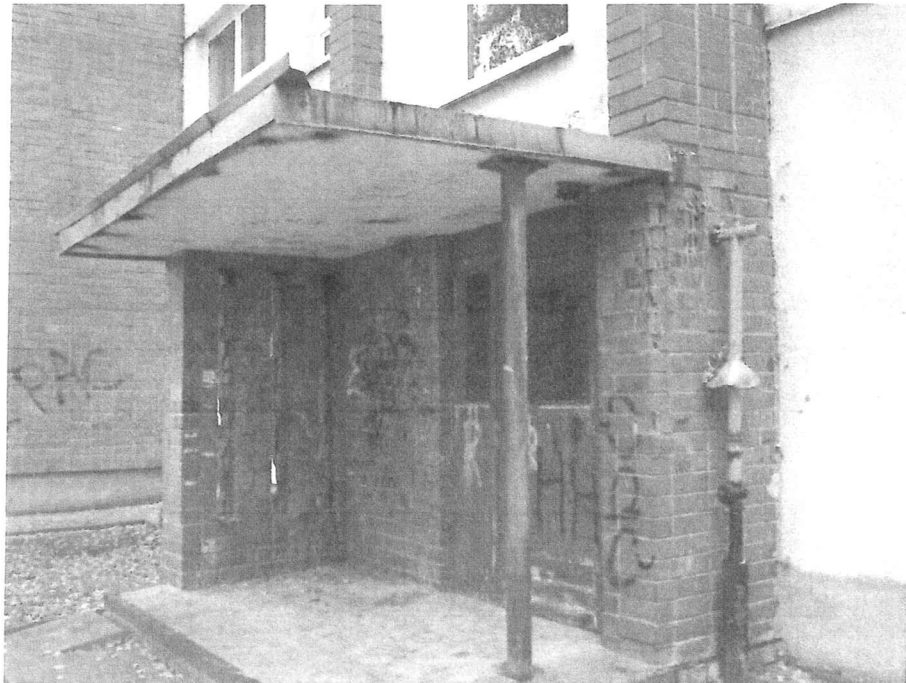
2.attēls. Ieejas durvju bloks, nepieciešama ārdurvju nomaina, sadrupušo ķieģeļu remonts.
